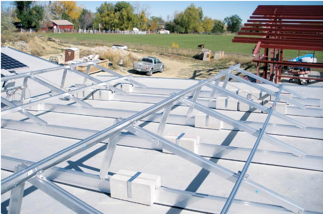
Gambar 3.12 Sistem atap datar dengan rel dasar horizontal yang dibebani balok beton (ballast)
